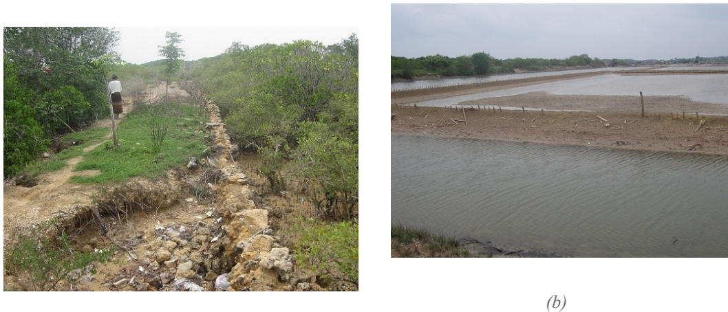
(a) (b) Gambar 7. (a) Tanggul penahan ombak rusak (jebol) sehingga menyebabkan masuknya (intrusi) air laut dan (b) kerusakan lahan tambak di Kampung Madegan Kelurahan Polagan
