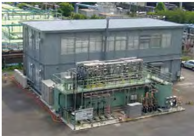
水処理実験プラントと実験棟
