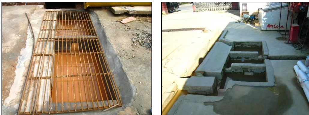
图 7.2-2 施工期废水沉淀池
