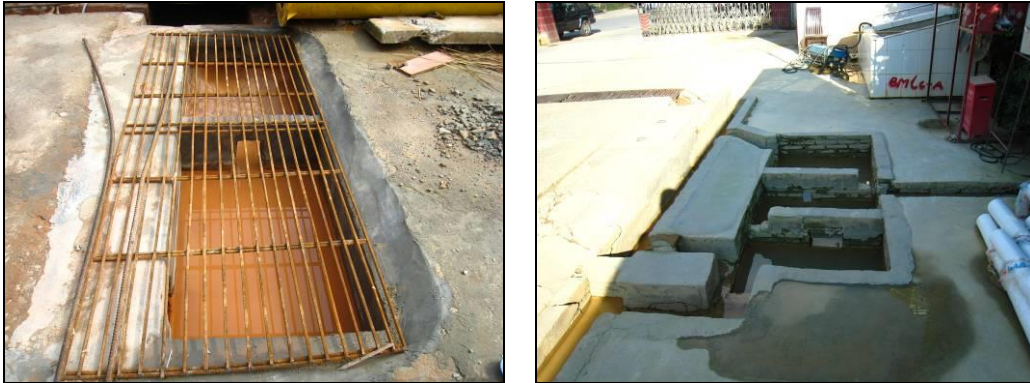
图 11.4-1 施工期废水沉淀池
