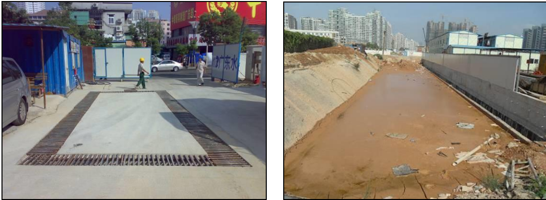
图 11.1-2 施工场地车辆清洗设备及泥浆干化池
