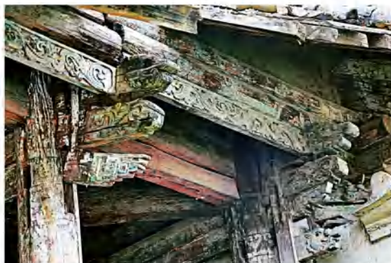
破旧的栋梁经受过风雨的摧残
