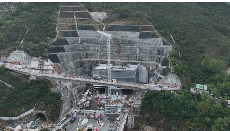
將軍澳–藍田隧道 - 東面通風大樓 East Ventilation Building, Tseung Kwan O–Lam Tin Tunnel
