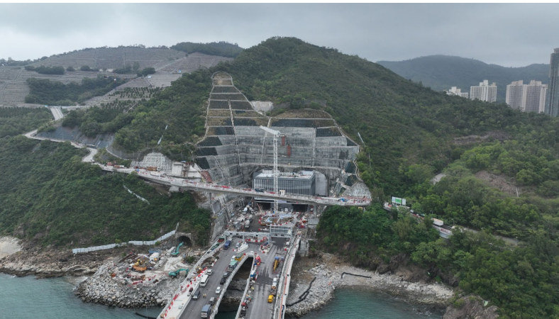
將軍澳-藍田隧道 - 東面通風大樓 East Ventilation Building, Tseung Kwan O-Lam Tin Tunnel
