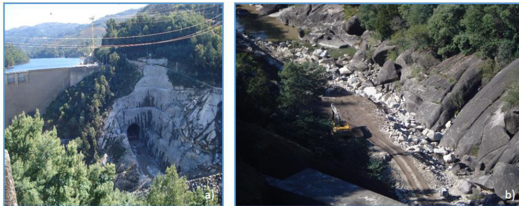
Figura 19. Construção de um túnel para eventuais situações de cheia na Barragem da Caniçada. Fotos tiradas em 2016.
