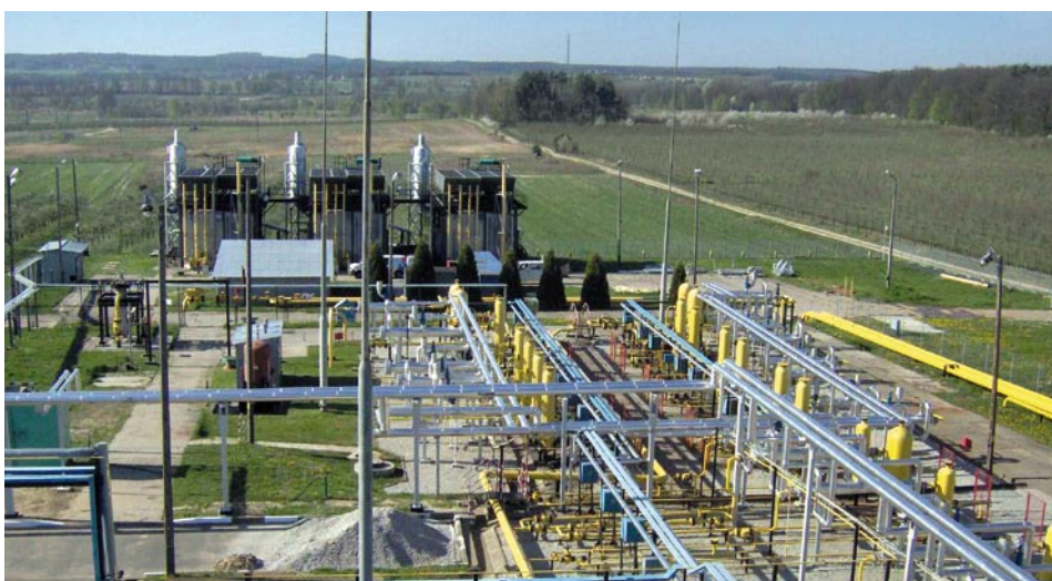
Tłocznia gazu na terenie „starego” PMG Wierzchowice
