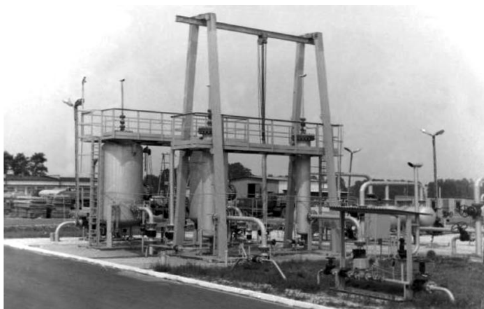
Odrętcialnia Grodzisk – instalacja oczyszczająca gaz z rtęci wybudowana w połowie lat 80.
