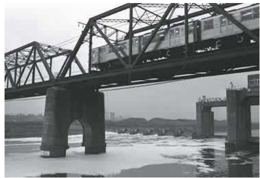
洗剤の泡で洗われる多摩川丸壺の橋脚 1979（昭和54）年（東京都環境局）
