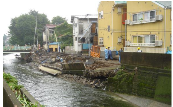
2005（平成 17）年の集中豪雨による堤防の破損（中野区）
