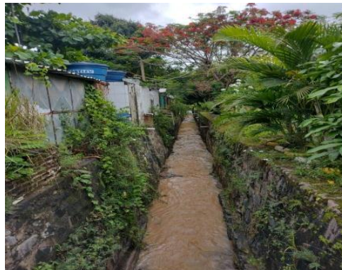
Figura 03 – Canos de esgoto com lançamento em águas pluviais
