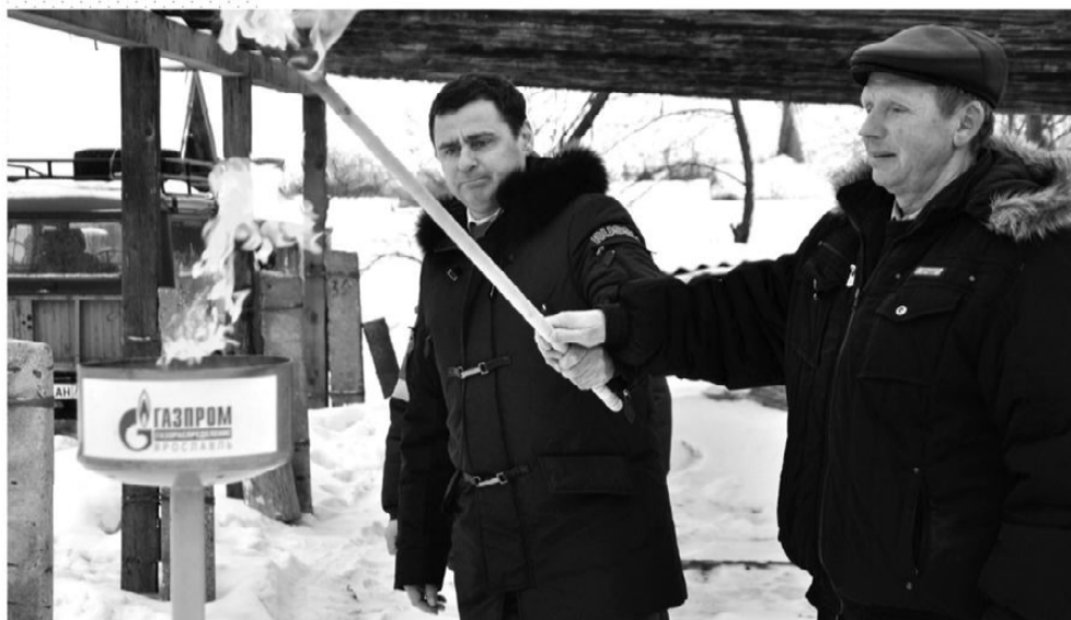
Дмитрий Миронов (слева) в с. Дмитриановское Ростовского района на запуске межпоселкового газопровода
