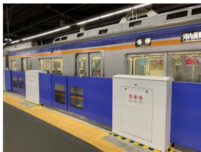
難波駅に設置済みの大開口ホーム柵
