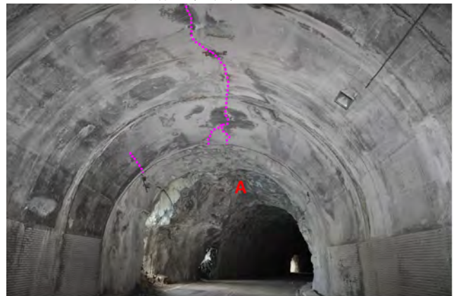
照片十五 清水隧道（已廢棄）襯砌裂縫（虛線標示）與1996年地震掉落之未襯砌段隧道（A處）
