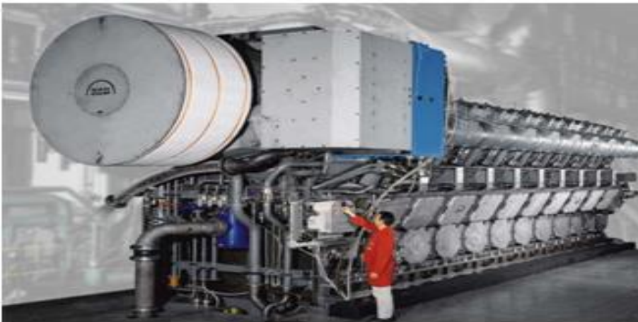
Figura 1.3. Motor de combustión interna de una central eléctrica fuel oíl. Fuente: MAN (2012).
