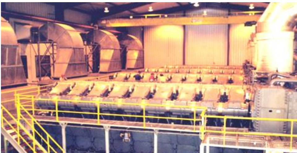
Figura 2.1. Motores de la central eléctrica.
