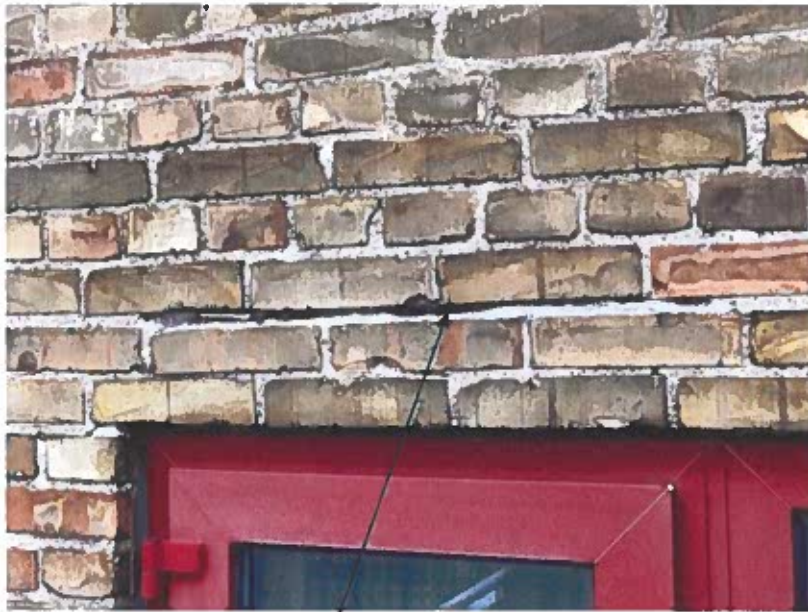
Løse fuger over vindues elementer
