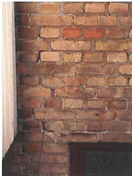
Løse fuger i facade
