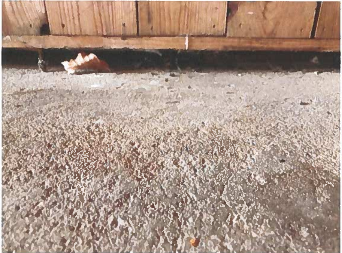
Sænkning af gulv under skillerum. Sænkningen er visse steder op til 20 mm
