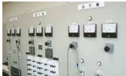
▲模擬送電線装置
