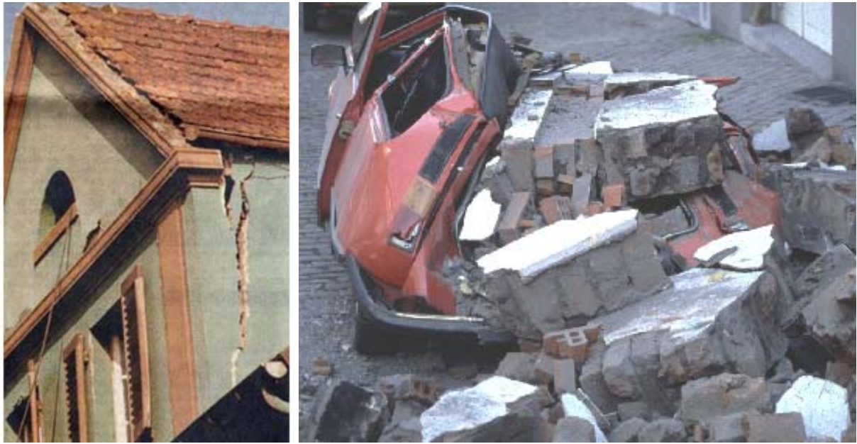
Figure 1. Dégâts typiques des tremblements de terre modérés dans le nord-ouest de l'Europe : détachement d'une façade de maison à Heinsberg (séisme de Roermond en 1992 – Het Laatste Nieuws , T. Van Galen) et l'écrasement d'une voiture par des débris de cheminée à Liège (séisme de Liège de 1983).
