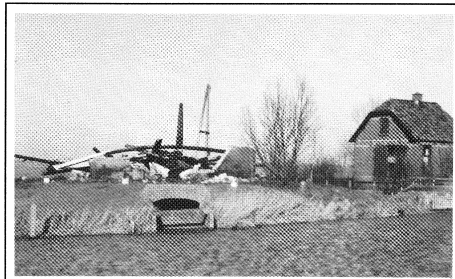
10. Doordat de staart boven de wind stond, is deze vrijwel onbeschadigd gebleven. De onderkant van de staart wijst naar het ZW. (ongeveer wat aangeeft, dat de molen met de achterkant in de wind stond. Vergelijk deze foto eens met die op bladzijde 16. De as staat rechtop.
