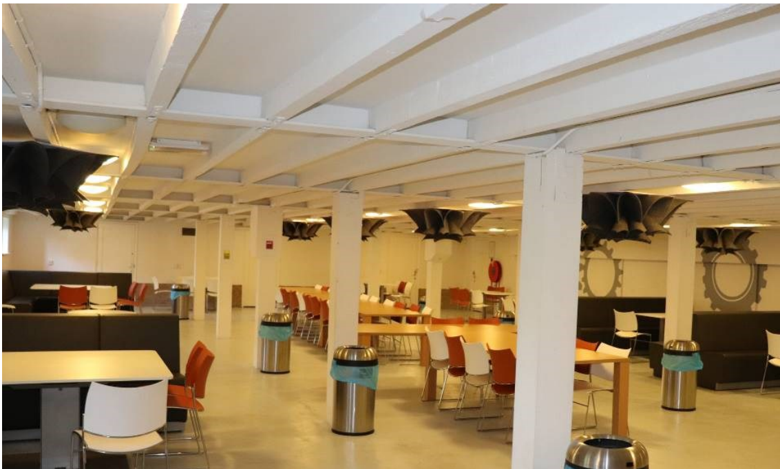
Overzicht van de kantine onder de gymzaal in de noordoostvleugel, gezien naar het oosten.
