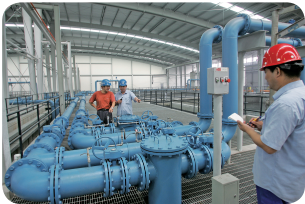
照4-11 2007年，建成的气浮净化车间内景 (区建委提供)
