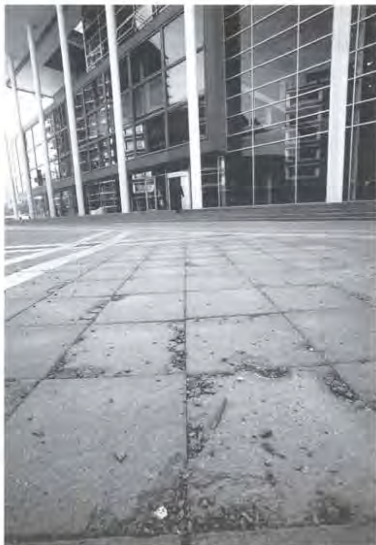
De beschadigde tegels op Plein 1992
