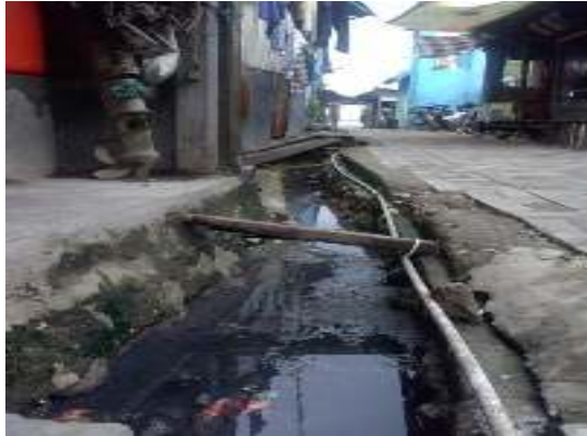
Gambar 36 : Kondisi Drainase Sumber : Survey Maret 2015
