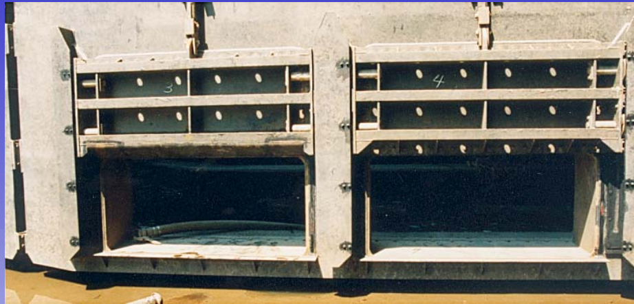
Rollschützen eines Stemmtores
