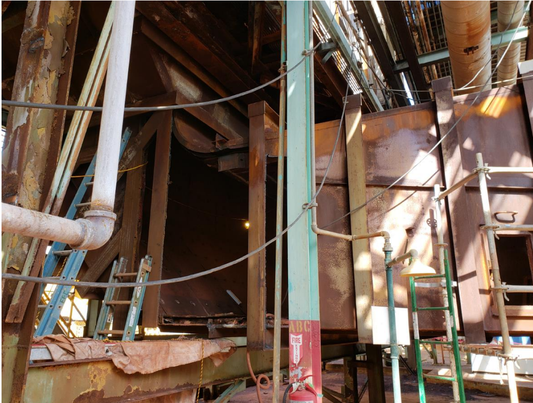
Figure 3-12 — HRSG 2-1 Inlet Duct
