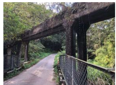
老朽化がみられる用水路の橋(心見地区)
