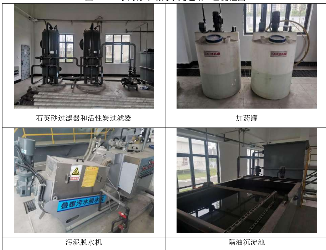
图9.1-4 小海停车场污水处理站照片
