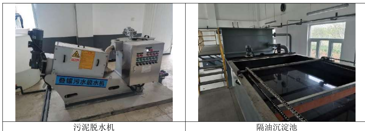
图 2.3-6 车辆段污水处理设备
