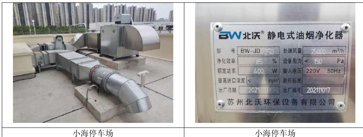
图10.1-1 平东车辆段和小海停车场油烟净化装置照片
