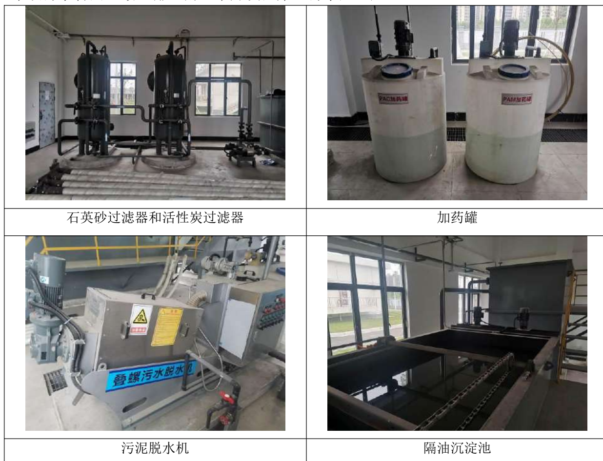
图2.3-7 小海停车场污水处理站照片
