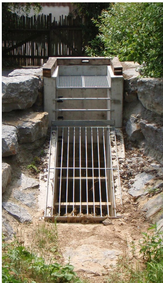
Ein Gitter verhindert die Verstopfung des Einlaufs, die Stauwand verhindert das Umfließen des Einlaufs und hält angeschwemmtes Gehölz zurück.
