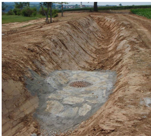
Mäandrierender Graben mit Einläufen leitet Starkregen ab und gedrosselt ins Kanalnetz ein.
