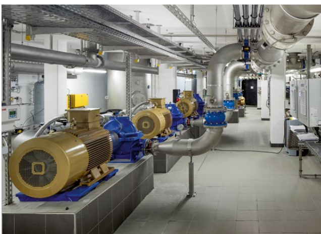
Reinwasserpumpwerk im Untergeschoss nach Fertigstellung
