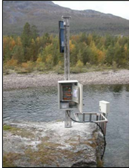
Figur 5.2: Moderne hydrometrisk stasjon med trykksonde, solcellepanel og automatisk dataoverføring. Foto: NVE
