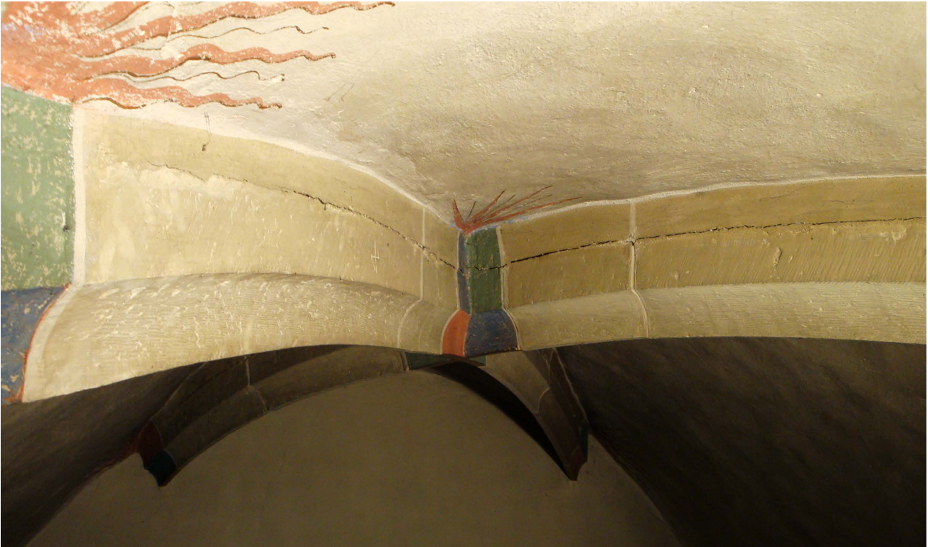
▲ Risse im Gewölbe vor der Sanierung
