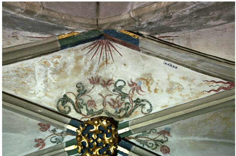
▲ Salzausblühungen und Verfärbungen im Gewölbe einer Seitenkapelle
