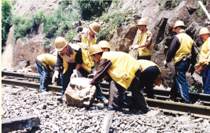
2004年3月10日，梅七线瑶曲—田家嘴间K38+550处发生山体滑坡，工务人员紧急到达现场处置
