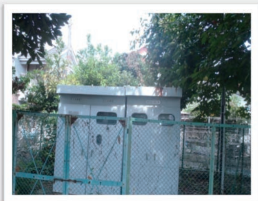
八小 設備劣化状況
