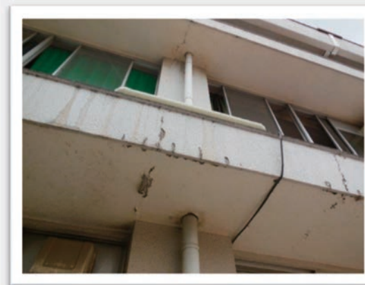
一中 外装劣化状況
