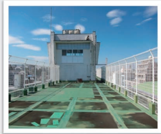
一中 屋上防水劣化状況
