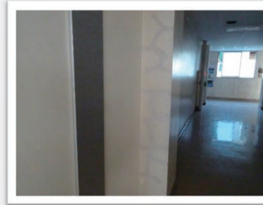
一中 柱のひび割れの状況
