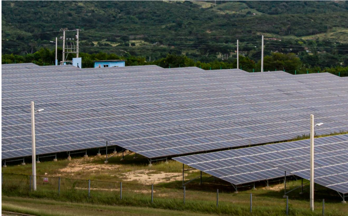
Solar power plant, Abel Santamaría, Santiago de Cuba
