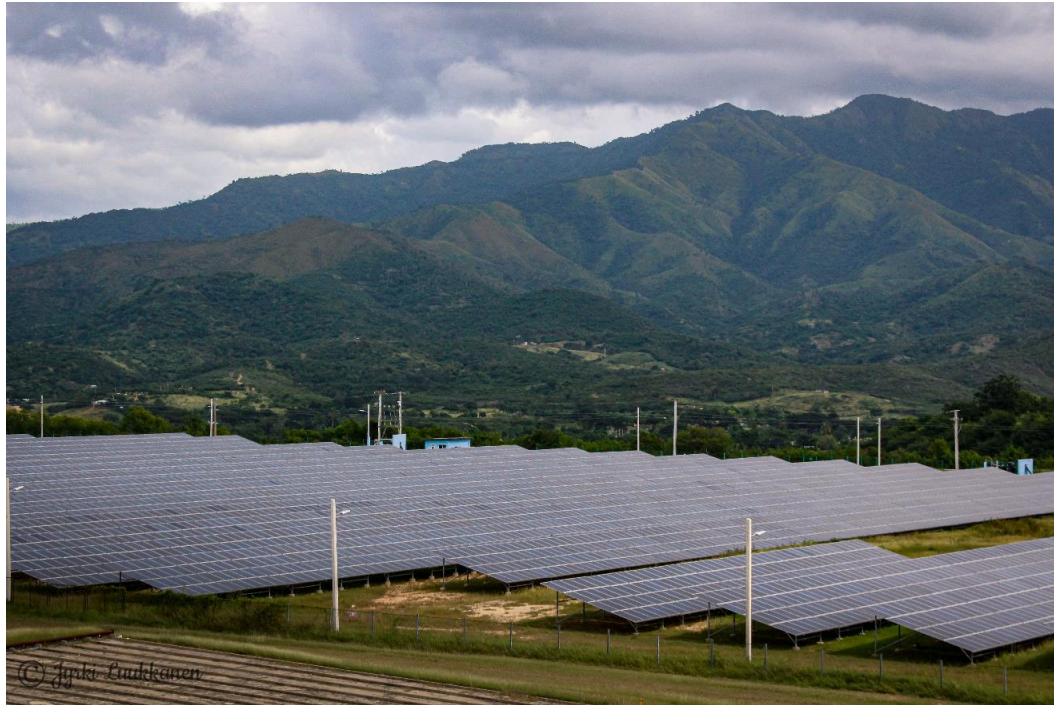
Solar power plant, Abel Santamaría, Santiago de Cuba
