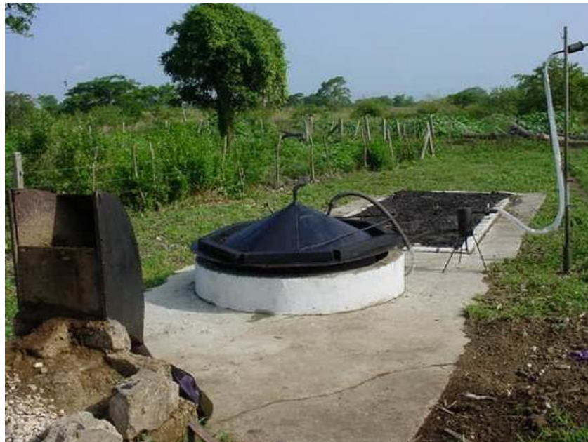
Figura 52: Tanque de descarga lleno.
