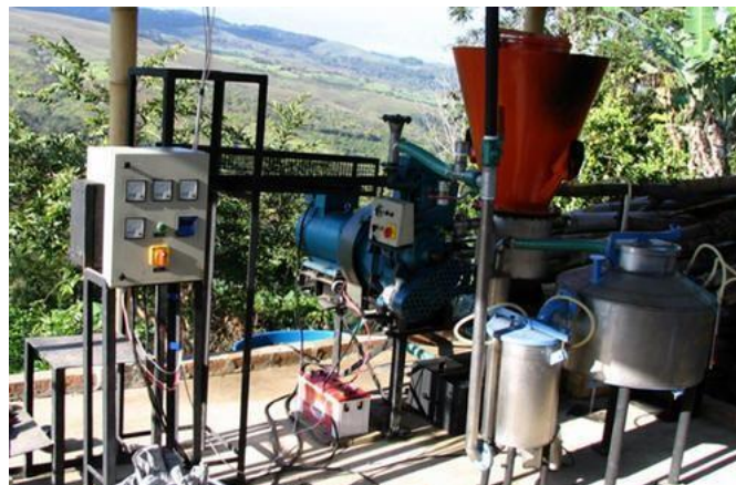
Figura 109: Sistema de Gasificación FGB 20 de la finca TOSOLY, Santander Colombia.
