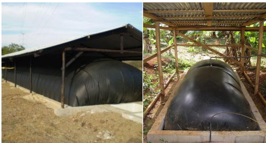
Figura 88: Biodigestor protegidos con techo para aumentar su vida útil.
