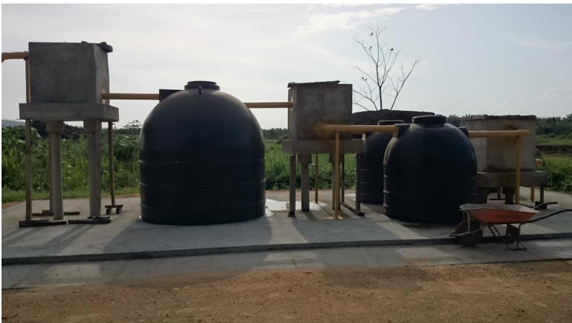
Figura46: Tanque de mezcla artesanal.
