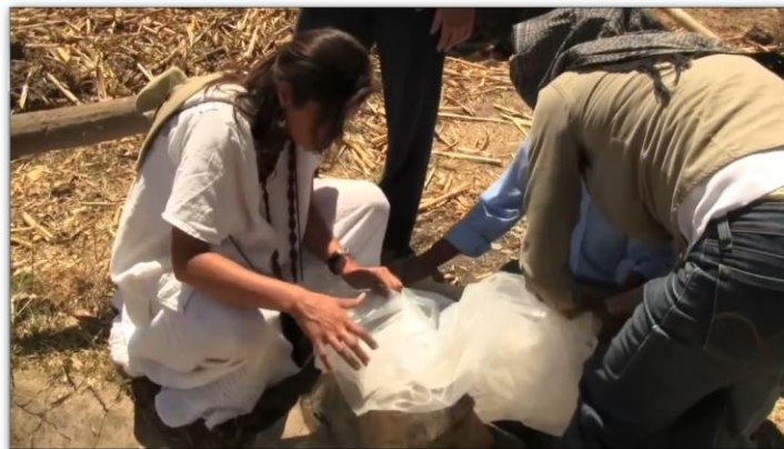
Figura 72: Salida del plástico en la tubería 02.
