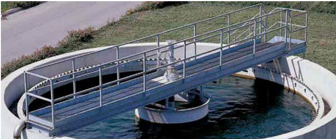
Figura 45: Tanque de mezcla de planta de tratamiento de aguas residuales.
