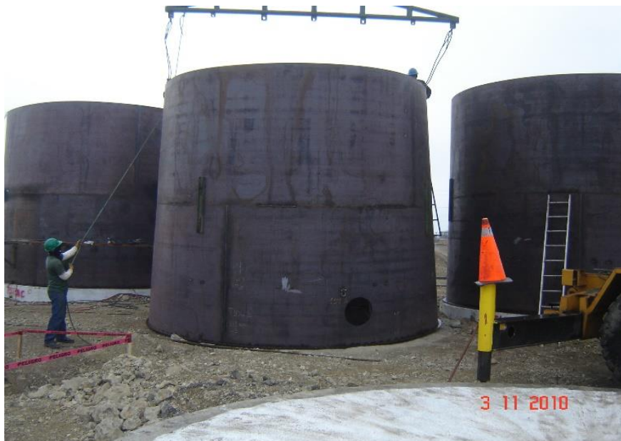
Imagen No 24. Tanques de HFO
