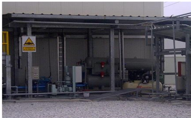
Imagen No 21. Sistema de aire comprimido
