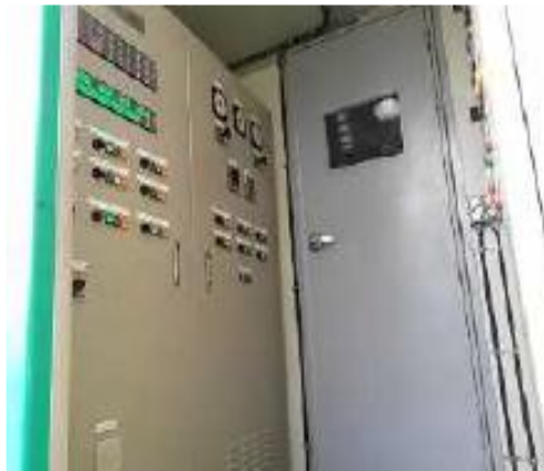
Imagen No 17. Sistema de control HTU
