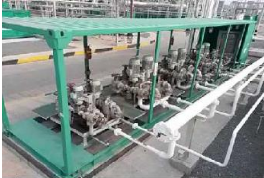
Imagen No 16. Bombas de alimentación
