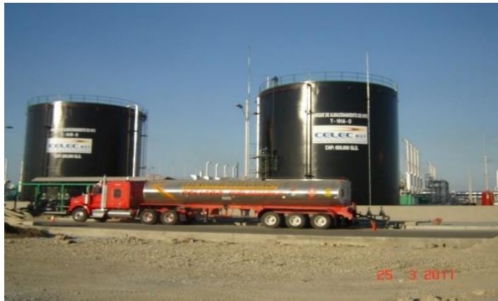
Imagen No 5. Tanques de HFO
