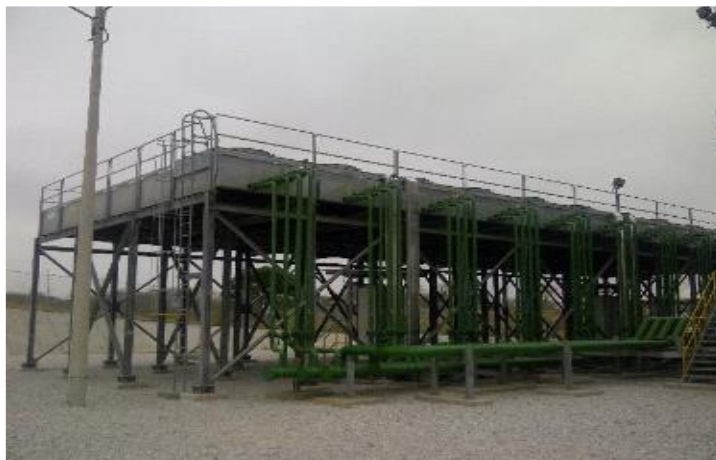
Imagen No 6. Sistema de ventilación
