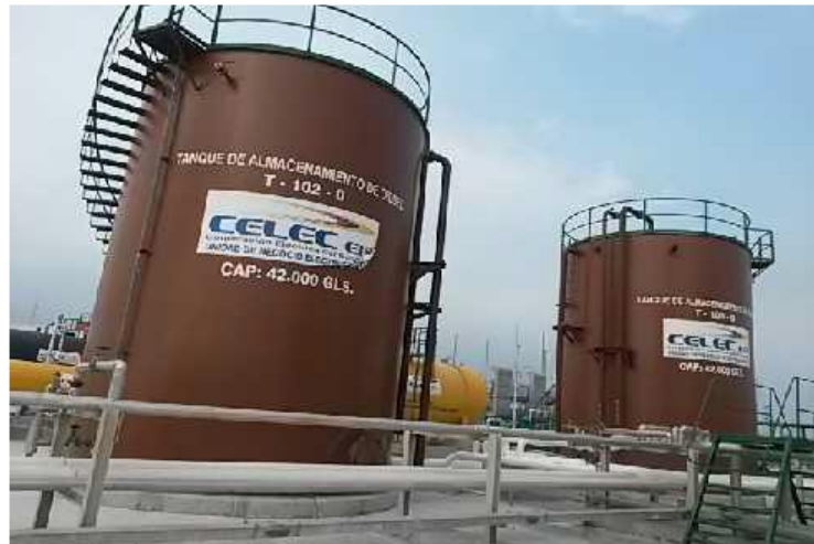
Imagen No 11. Tanques de almacenamiento de combustible HFO
