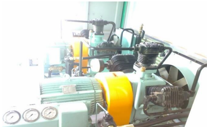
Imagen No 7. Sistema de compresión de aire
