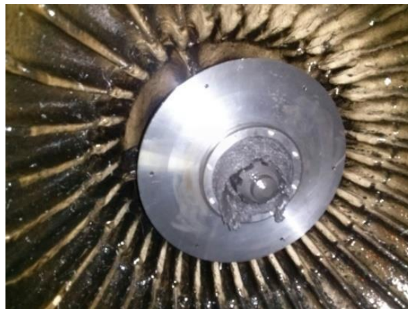
Imagen No 29. Alta contaminación por hollín en alabes de turbina
