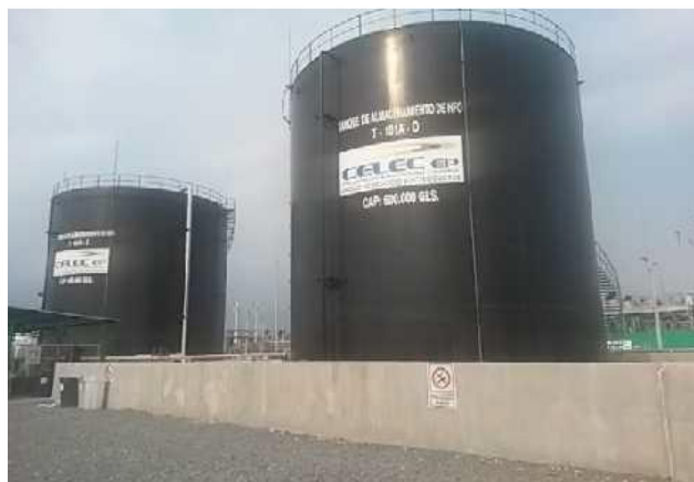
Imagen No 10. Tanques de almacenamiento de combustible HFO
