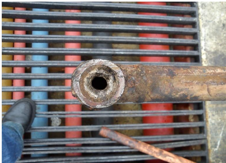
Imagen No 32. Incrustaciones sólidas debido al mal tratamiento del agua
