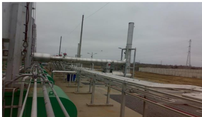
Imagen No 3. Calderas de la central Santa Elena II
