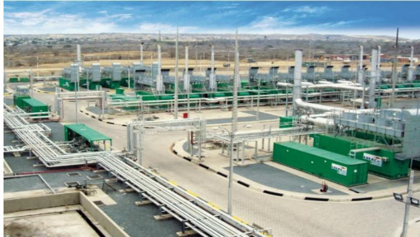
Imagen No 2. Instalaciones de la Central Térmica Santa Elena II
