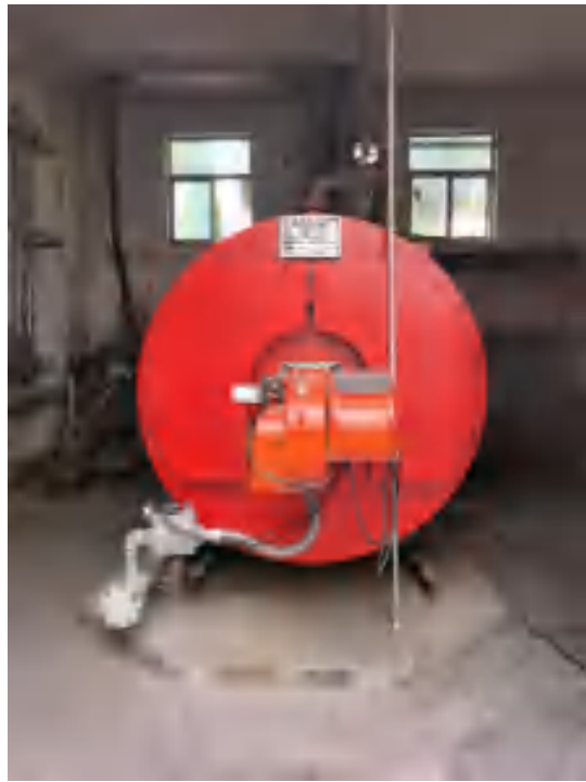
生活区 1.4MW 燃气热水锅炉
