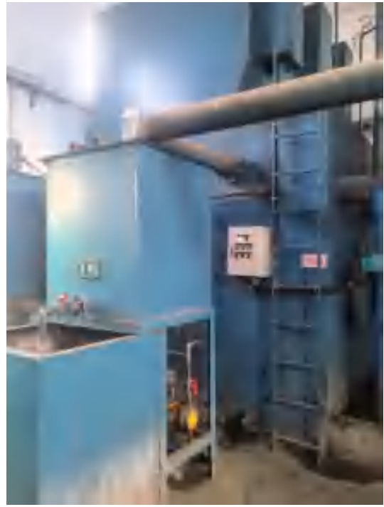
矿井水处理装置（生产区）
