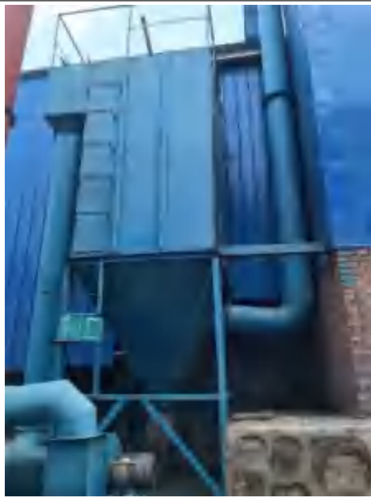
筛分除尘设施
