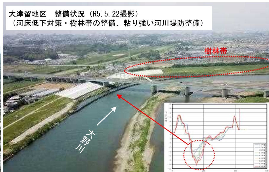
高流速により河床低下が著しい左岸の河床低下対策を実施中
