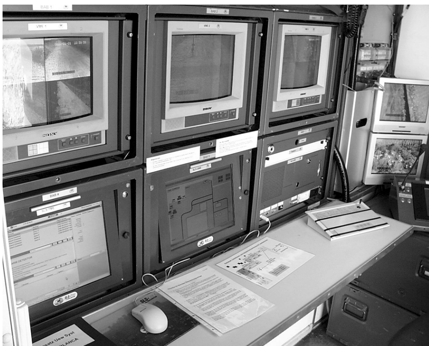
Centrale de surveillance
