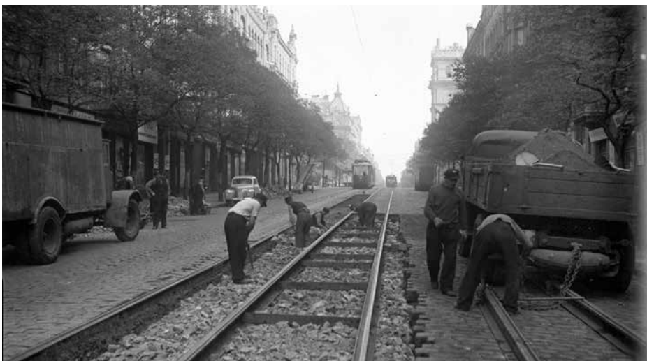
Přestavba Korunní ulice v Vinohradech v roce 1956. Napravo vykukuje budova vodárny, za níž měla vzniknout jedna z nových měníren, jejíž stavba se však vůbec neuskutečnila. Sběrka: Archiv DPP
