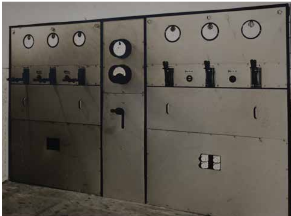
Pohled na usměrňovače z ČKD instalované v měnírně Prštne ve Zlíně v roce 1954. Sbírká: Libor Hinčica
