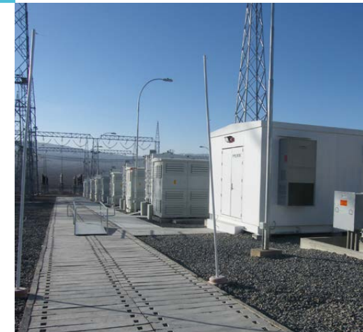
Almacenamiento de Energía con baterías
