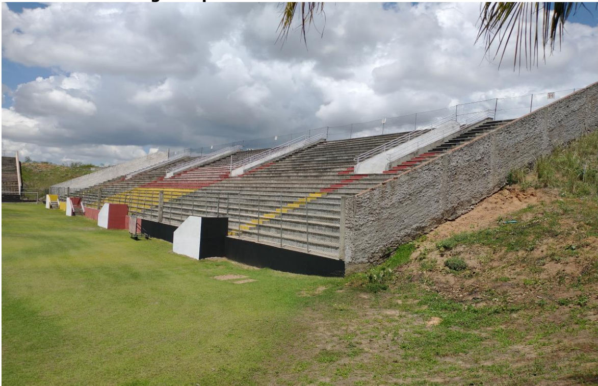
Foto 17 – Vista da arquibancada que apresenta recalque diferencial.
