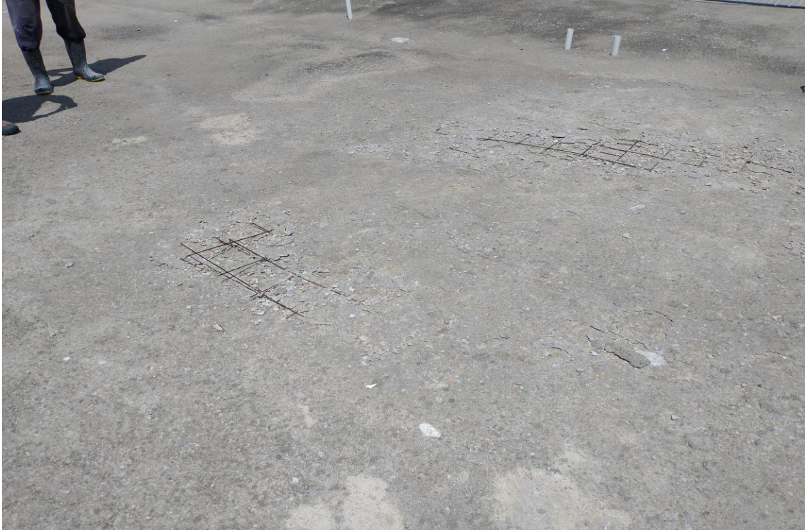
Foto 16 – Laje do lance de arquibancada que compreende os setores 10 a 14 com ferragem aparente
