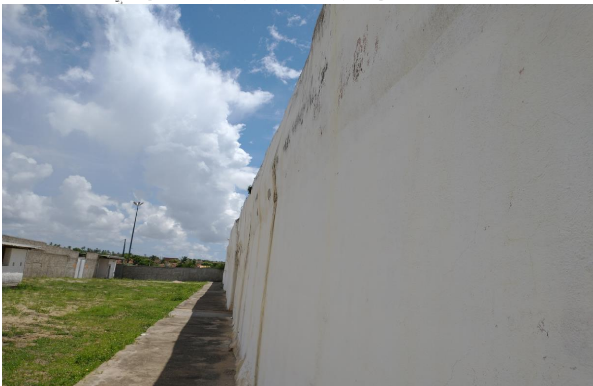
Foto 12 – Parede apresentando recalque
