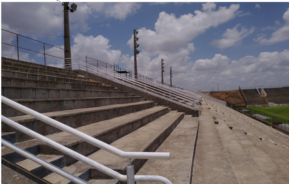
Foto 10 – Arquibancada construída sobre talude.
