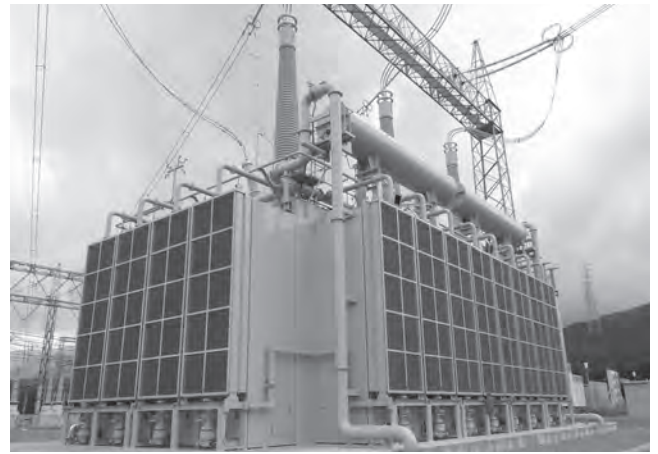
東京電力株納め新富士変電所1号主要変圧器 (1500MVA, 525 / 275 / 63kV)
