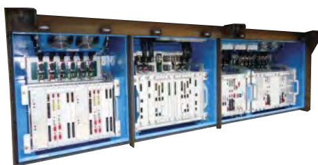
ATACS車上制御装置
