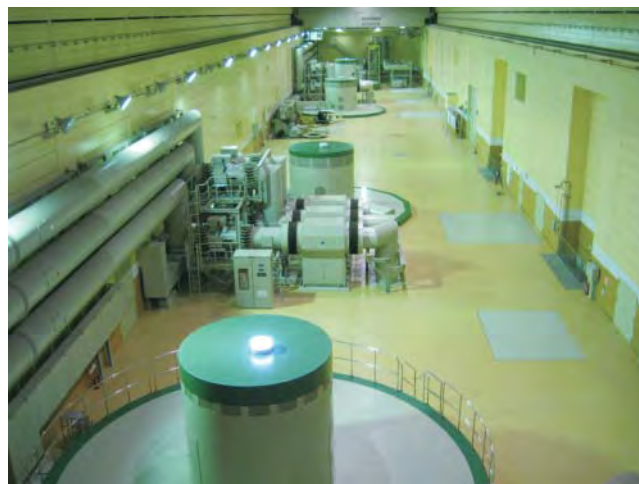
小丸川発電所内部(手前から2台目が2号機)
