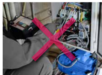
Hierdoor zijn gecompliceerde metingen van isolatieweerstand niet meer nodig.
