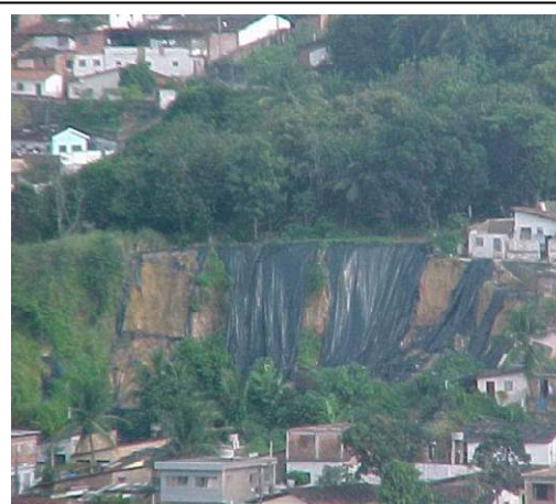
Figura 1.12 – Recife: Proteção por lonas plásticas com falhas
