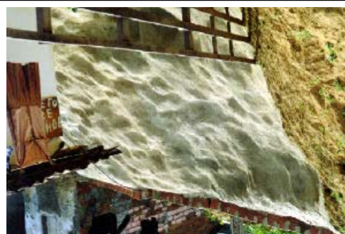
Figura 1.13 - Camaragibe: Revestimento da encosta em argamassa sem tela
