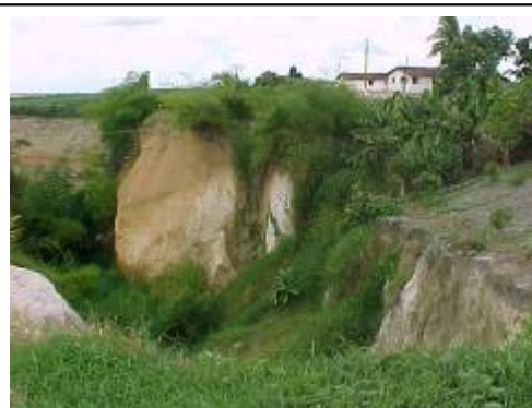
Figura 1.10 – Araçoiaba: Erosão por voçorocas
