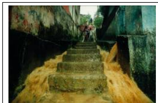
Figura 1.8 – Recife: Subdimensionamento de canaletas em morro
